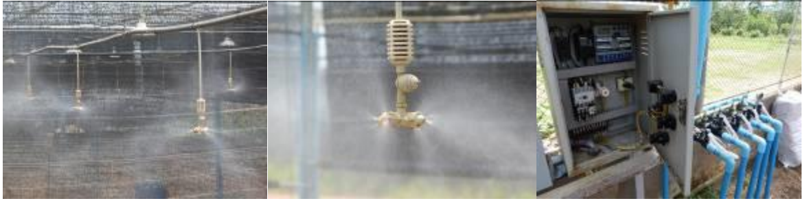
ภาพที่ ๔ การทดสอบระบบให้น้ำแบบพ่นหมอกเพื่อช่วยลดอุณหภูมิในโรงเรือน
