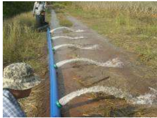
(ข) Gated pipe ขนาดช่องจ่ายน้ำ 1 1/2 นิ้ว
