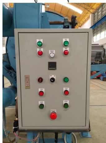
รูปที่ 18 ตู้ควบคุมการทำงานของเครื่อง
